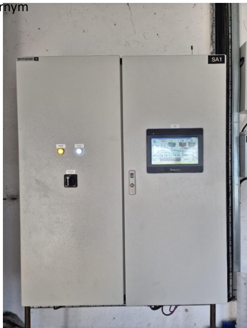
Szafa sterownicza – pompownia główna Oczyszczalni Ścieków – Element AKPiA wtórnym
