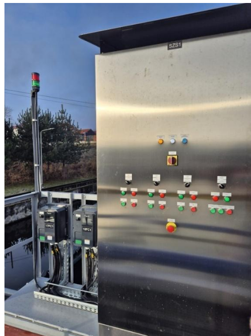
Szafa sterownicza – Oczyszczalnia Ścieków - Element AKPiA sterujący osadnikiem
