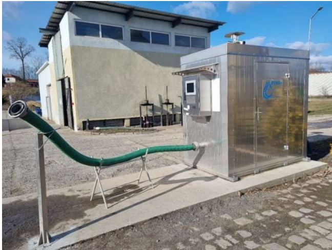
Stacja zlewna ścieków dowożonych
